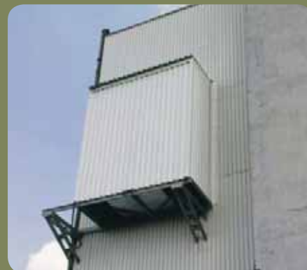
Tłumik zabudowany na czepni wentylatora układu chłodzenia przetwornic maszyny wyciągowej na terenie Oddziału KWK „Jankowice” Kompanii Węglowej S.A.
