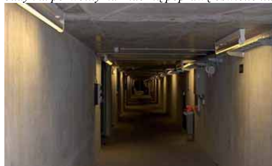
Podziemny korytarz pozwala pracownikom przemieszczać się bezpiecznie, izolując ich od wysokiego napięcia
