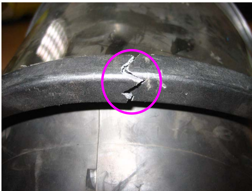
Rys. 5.11. Pęknięcie ramki wizjera
