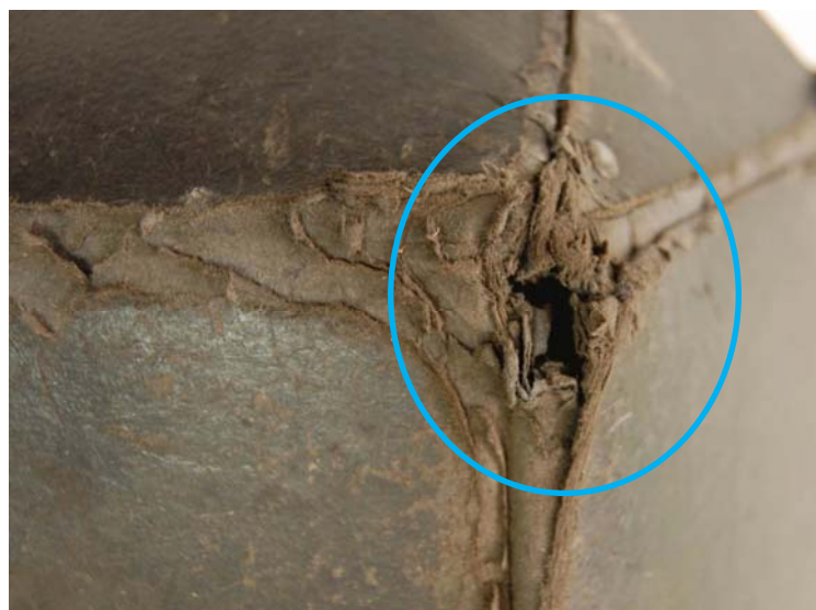
Rys. 4.24. Uszkodzenie na łączeniach powodujące utratę światłoszczelności, czyli brak ochrony przed UV i oślnieniem
